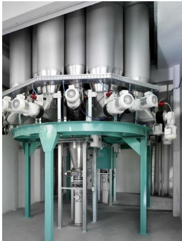
Figura 2: Sistema de dosagem de matéria-prima
