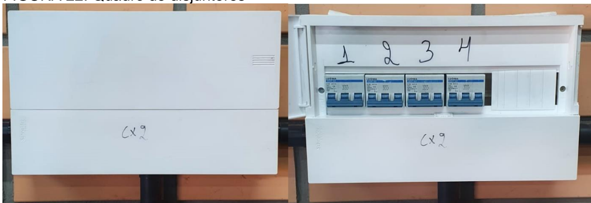
FIGURA 22: Quadro de disjuntores
