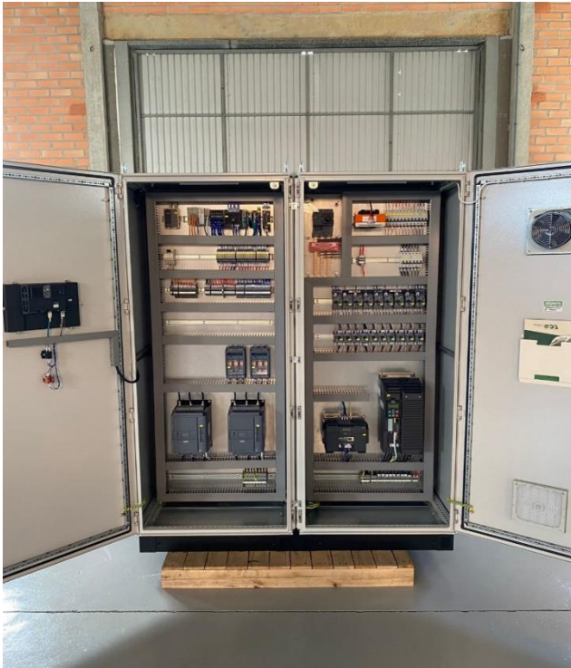
Figura 10: Visão interior do painel elétrico montado.
