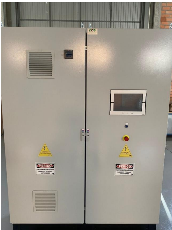
Figura 11: Visão exterior do painel elétrico montado.
