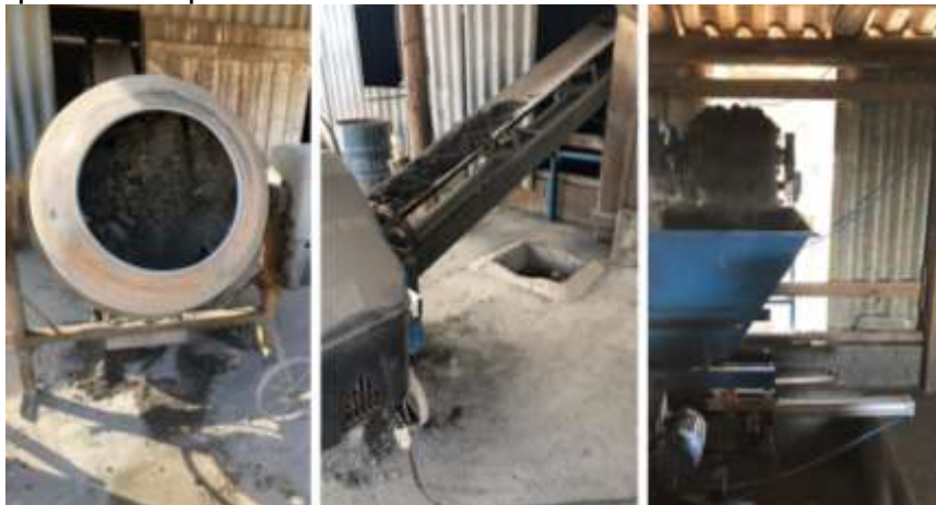
Figura 3: Homogeneização e abastecimento do silo da Máquina vibro-prensa.
