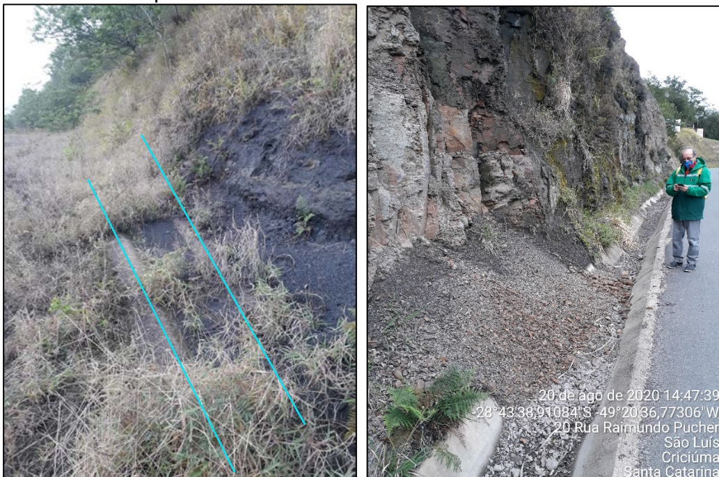
Figura 13: Canaletas de crista (esquerda) e de pé do talude (direita) com entupimento do sistema de drenagem superficial, contribuindo e acelerando os processos erosivos.
