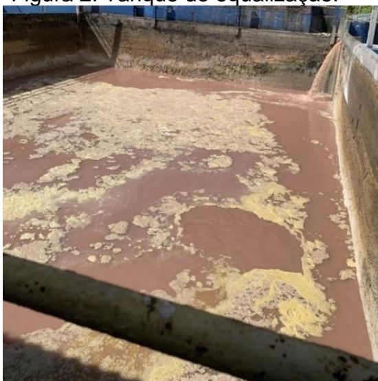
Figura 2: Tanque de equalização.
