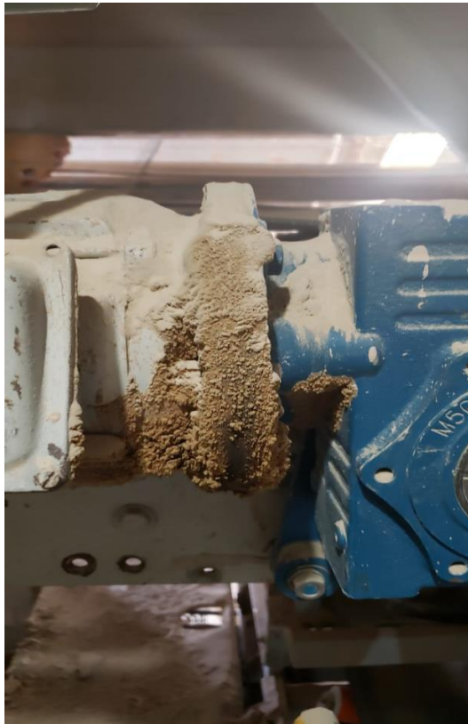
Figura 4: Pontos com acúmulo de graxa sobre as correias de massa.
