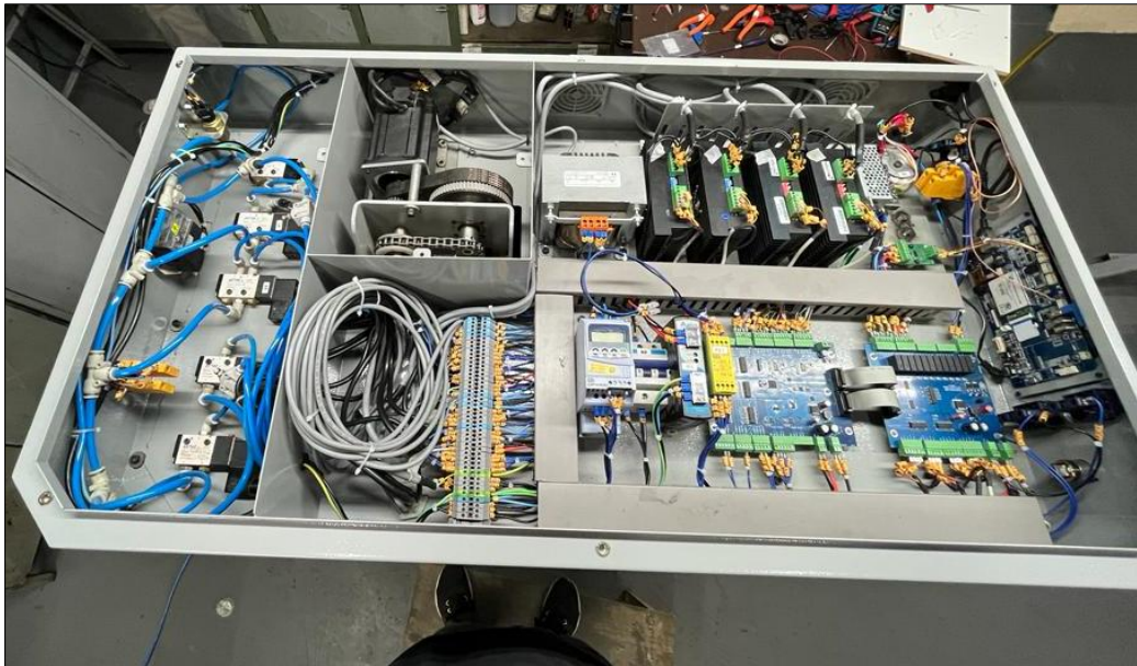
Figura 16: Hardware montado no painel elétrico da máquina
