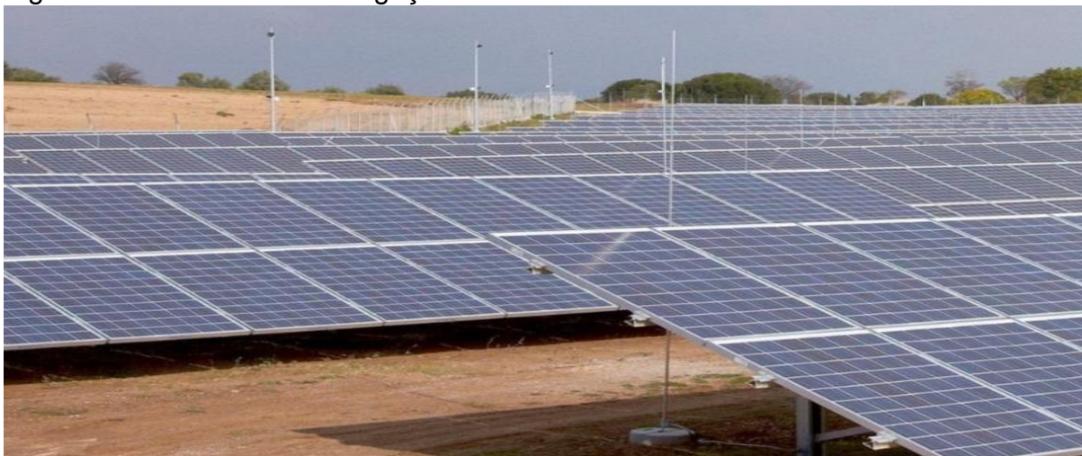
Figura 04 - Sistema de interligação através de mastros.
