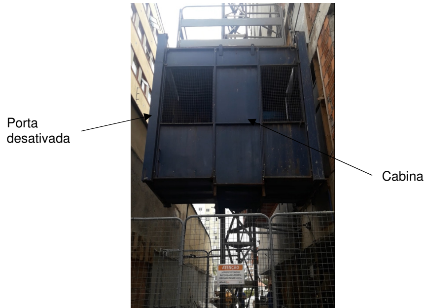
Figura 7: Elevador tipo cremalheira na obra.
