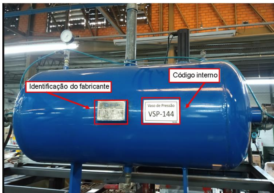
Figura 4: Identificação de segurança no vaso de pressão, (Do autor, 2020).
